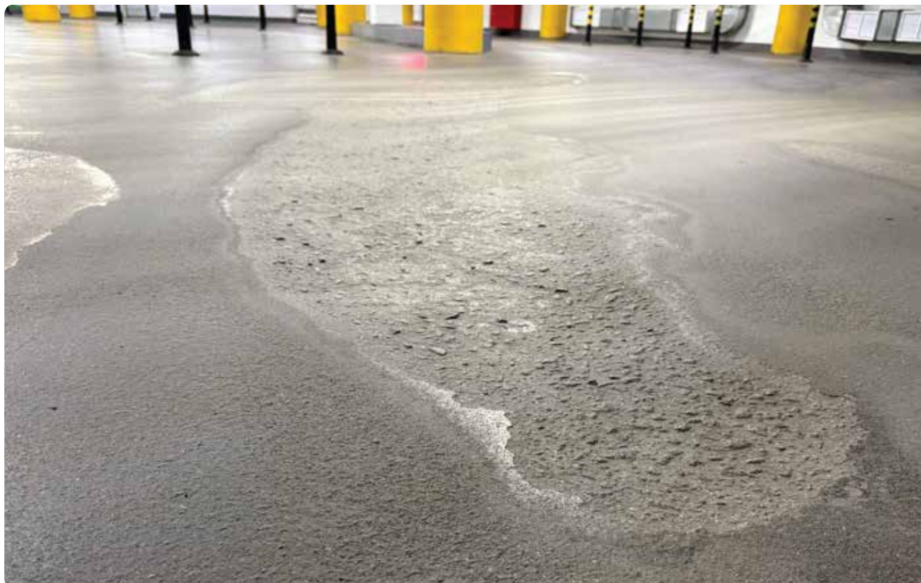
Выезд. Стертое полотно, ранее подвергалось ремонту.
