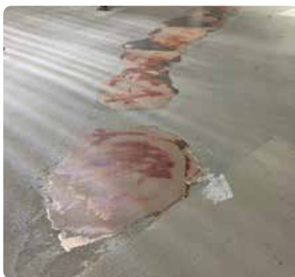
Поворот. Стерто до основания, но отремонтировано полимерным составом.
